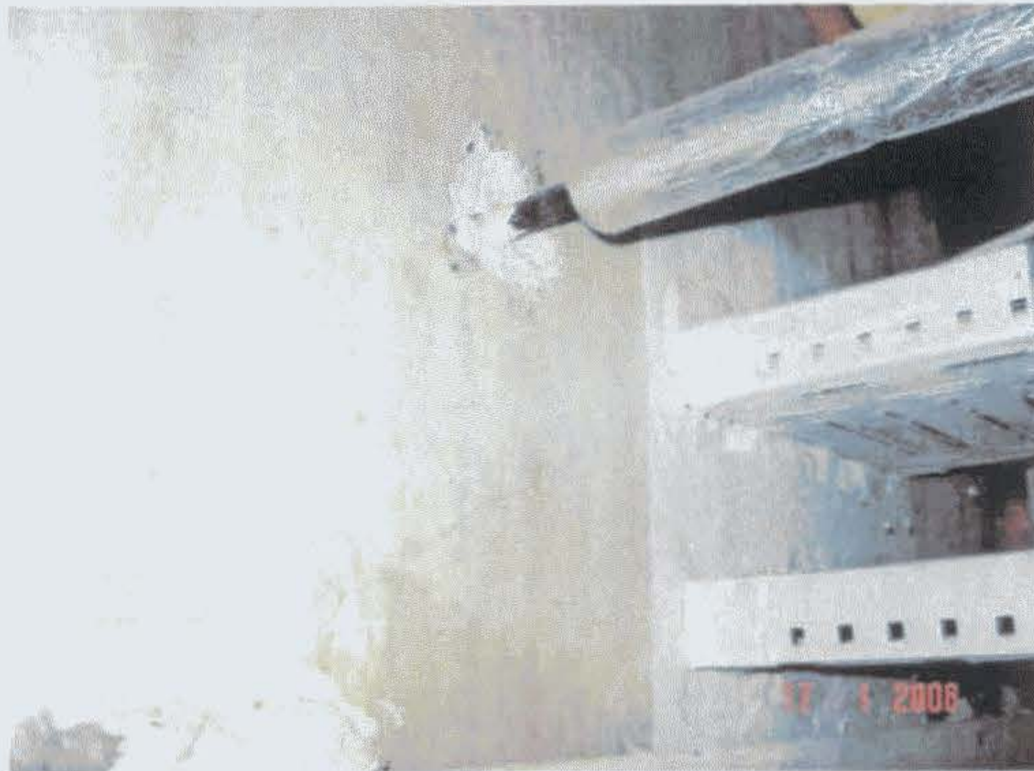
Bild 17: Bau L, Achse 2492 Flur, Brandwand Coating- Masse bei Wand- durchbruch
