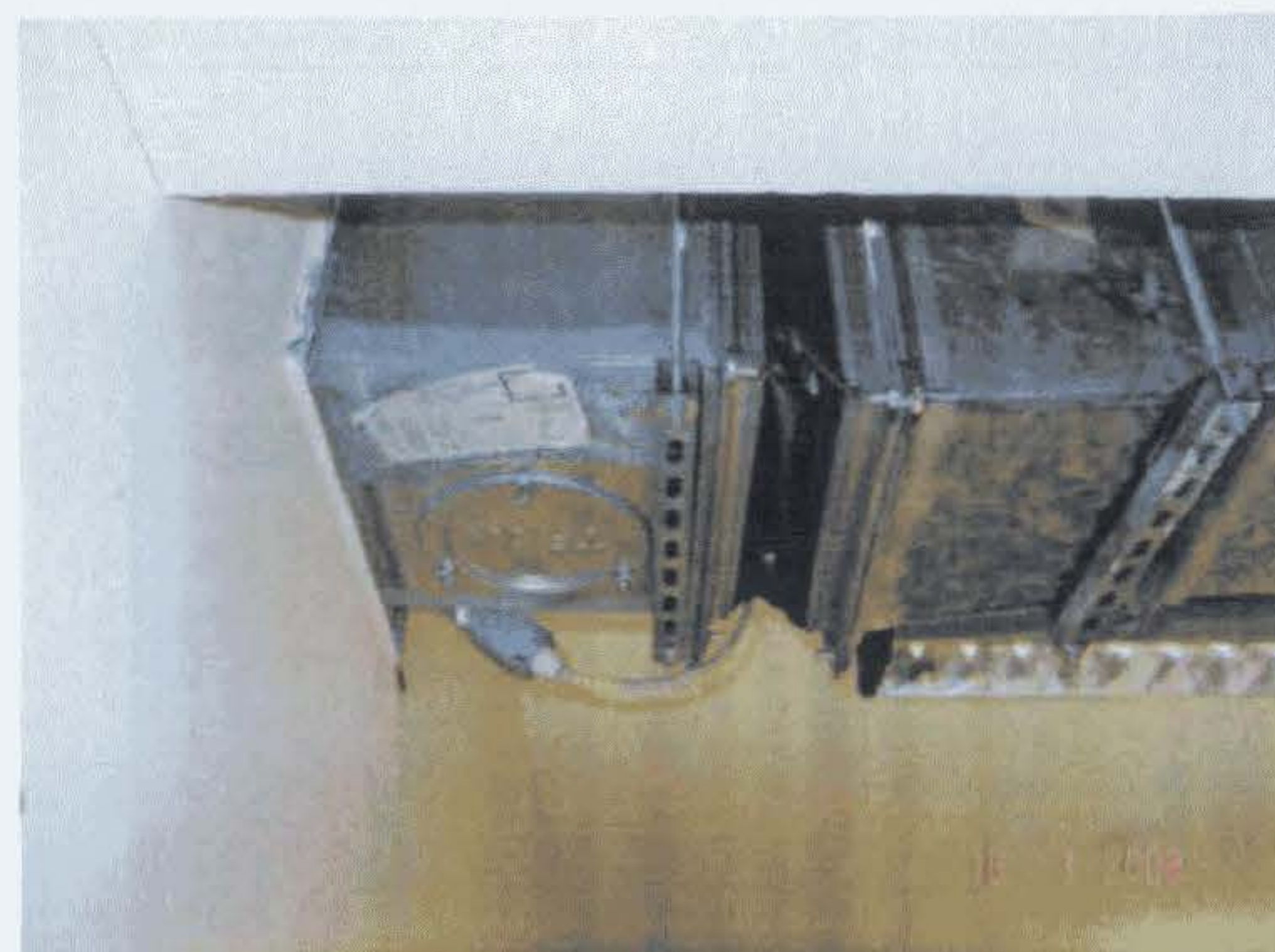
Bild 24: Bau K, Achse 217 Brandschutzklappe mit Asbestbauteilen
