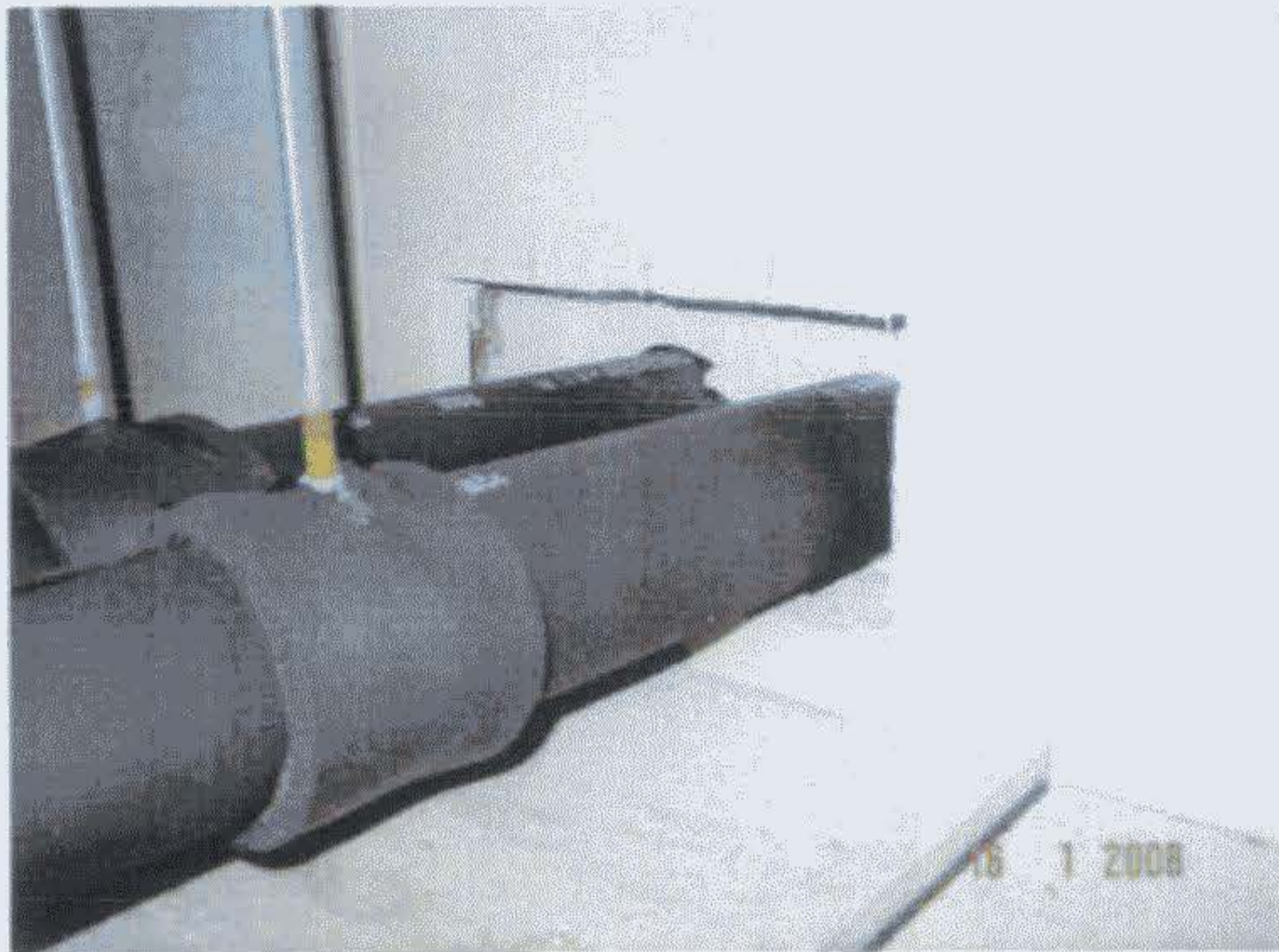
Bild 5: Bau K, Achse 228 Flur Platte über Zugangstür zum Technikraum auch unterhalb der Decke
