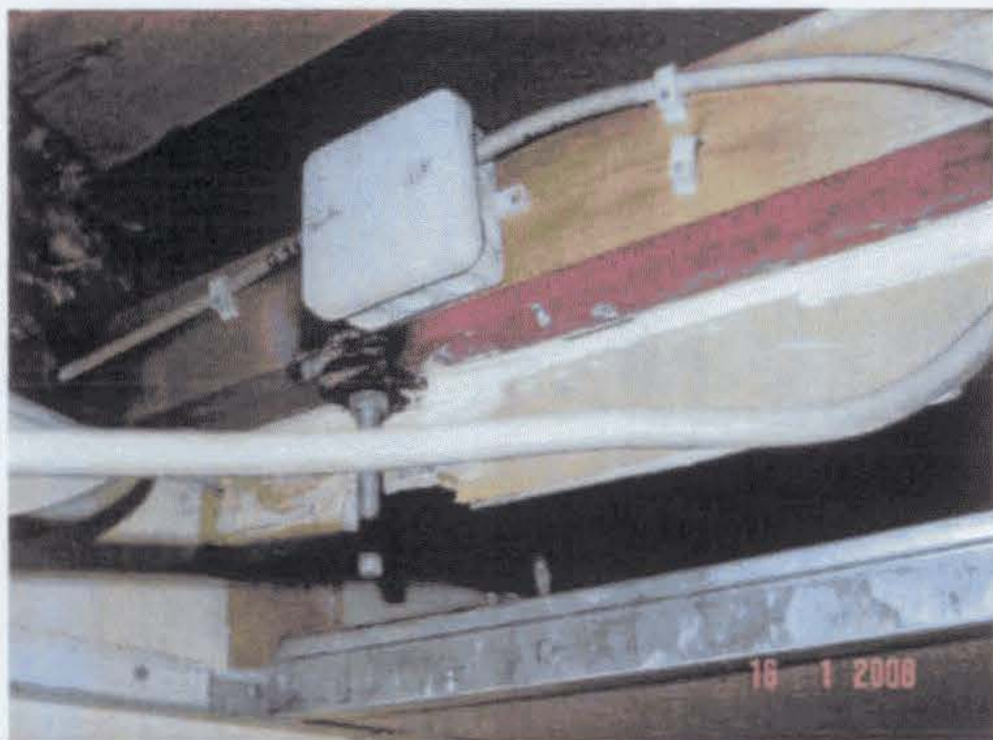
Bild 1: Bau K, Achse 222 Bürraum Dichtungsmaterial hinter ab- gehängter Decke bei GK- Plat- te
