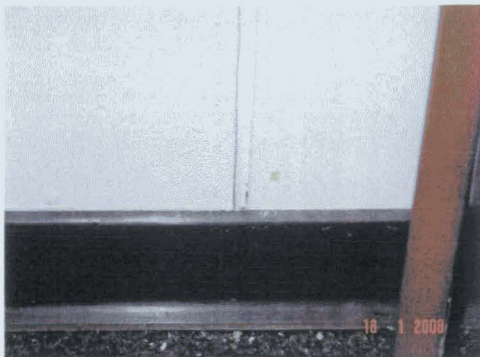
Bild 11: Bau K, Achse 341 Büroraum, 3. Flur Stütze mit Brandschutzverkleidung, daneben Pressspanverkleidungsplatte
