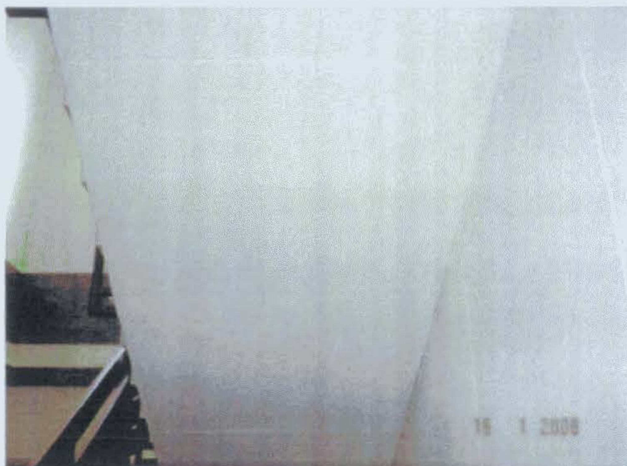
Bild 10: Bau K, Achse 244 Treppenhaus Wandverkleidungsplatten
